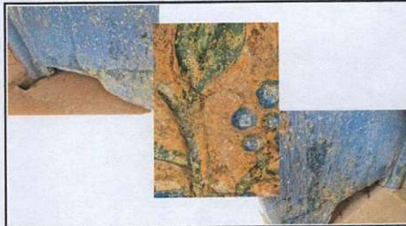
FOTO 10: La pila ya presenta rajaduras y el agua se filtra, no retiene nada de agua, habrá que cambiarla.
