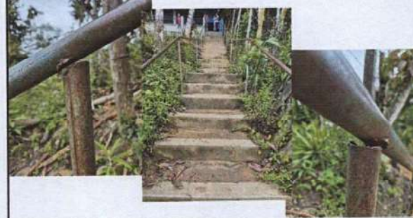
FOTO 4: La baranda de las gradas ya requiere mantenimiento, presenta oxido en su mayoría y algunos postes están safordos. Sería bueno repararla y pintarla.
