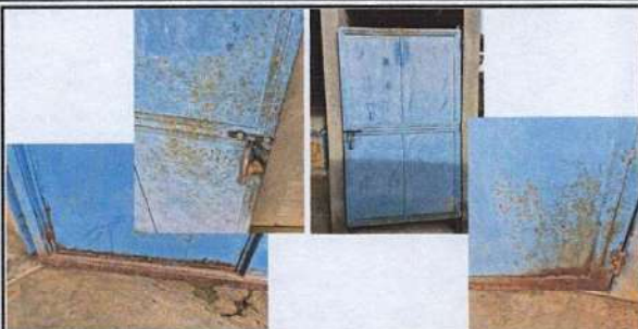
FOTO 7: Las puertas ya se están oxidando, sería bueno realizarle mantenimiento con lijado y pintura para prolongar su vida útil, mas el cambio de una puerta.
