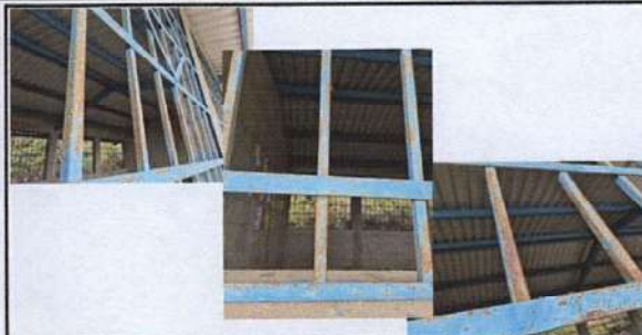
FOTO 8: De igual manera los balcones ya presentan oxidación y en algunas partes está quebrado, requieren mantenimiento con reparación, lijado y pintado.
