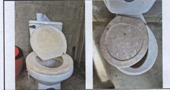
FOTO 6: Las tapaderas de plástico de los inodoros ya están safordas y quebradas, hay que cambiarlas.
