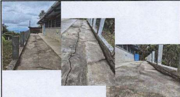
FOTO 1: Reparación de losa de patio frente a las aulas, presenta grietas y hundimiento de mas de 20 cm y existe peligro inminente para los niños.
