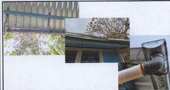
FOTO 5: Canal, soportes y bajadas están quebrados, safordos y oxidados, será bueno cambiarlo y dos bajadas de agua pluvial frente a corredor conducirlas con tubo hacia la caja de agua pluvial con la que ya.
